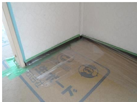
床にも漆喰が落ちます
